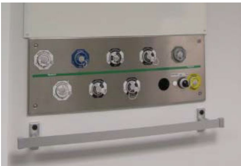
Gaslåda på operation för test av utrustning.
