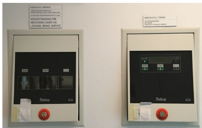
Nödavstängningslåda och tryckövervakare med larmtablå.
