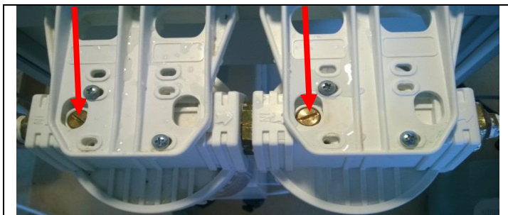
Bild 7: Avluftning av förfilter
