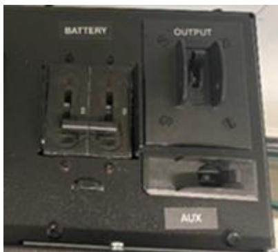
3. UPS BATTERY AV
