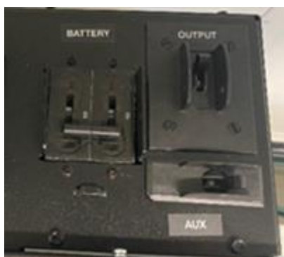
14. UPS BATTERY AV
