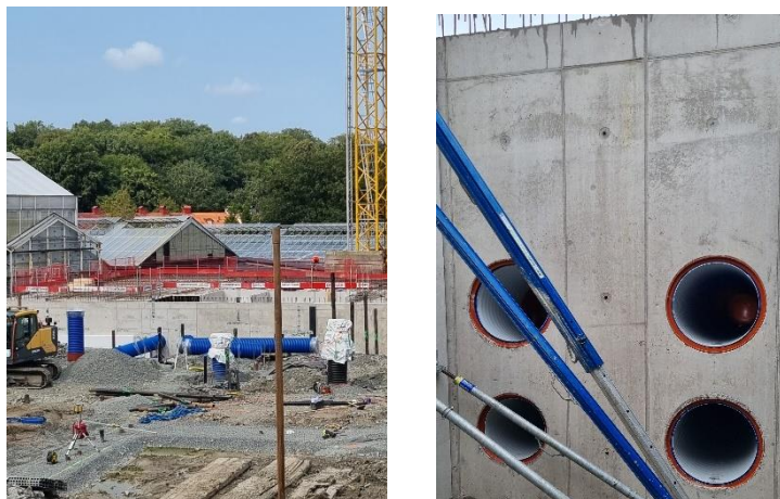
Figur 3. Ventilationsrör som skall försörja avdelningen "Djungel och ruin" är nu på plats i väggarna
