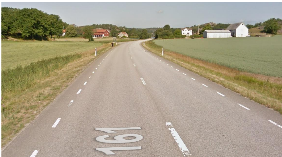
Figur 37. Del av väg 161, 1 km öster om färjeläget Skår, där vägstandard väl möter behov och funktion. Bildkälla: Google maps 2020.
