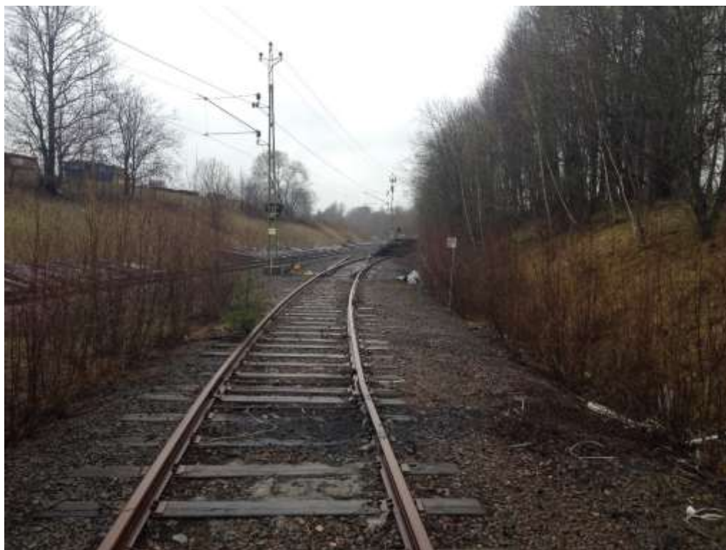
Figur 5-13. Industrispåret till Stora Ensos anläggning i Assberg ligger kvar men har berövats sin anslutningsväxel. Återupptagande av godstrafiken, vilket diskuterades under 2014 ställer krav på återinläggning av industrispårväxeln samt att industrispåret rustas upp.
