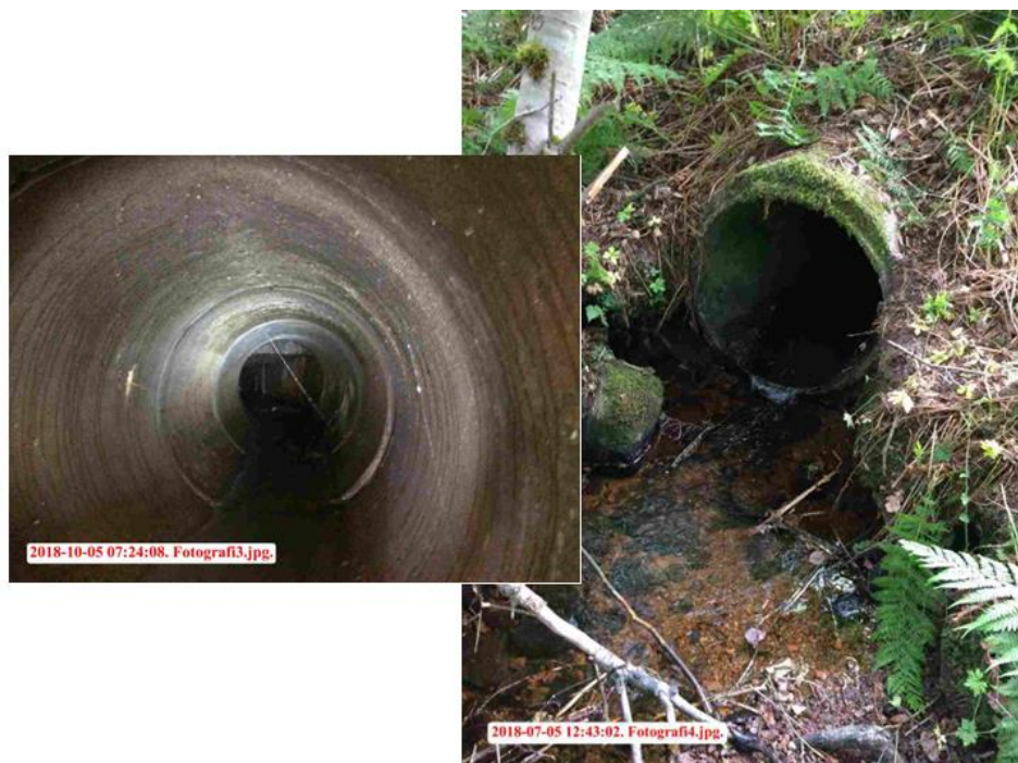
Figur 5. Bilden till vänster visar vägtrumma, bedömt vandringshinder vid lågt flöde. Bilden till höger visar vägtrumma med fall/stalp vid lågt flöde. (Bild: Trafikverket).
