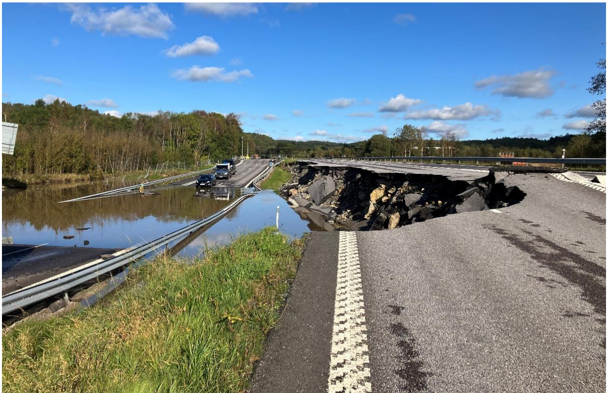
Figur 3. Del av E6, vid skredet vid Stenungsund. Foto: Jonas Axelsson, Trafikverket.
