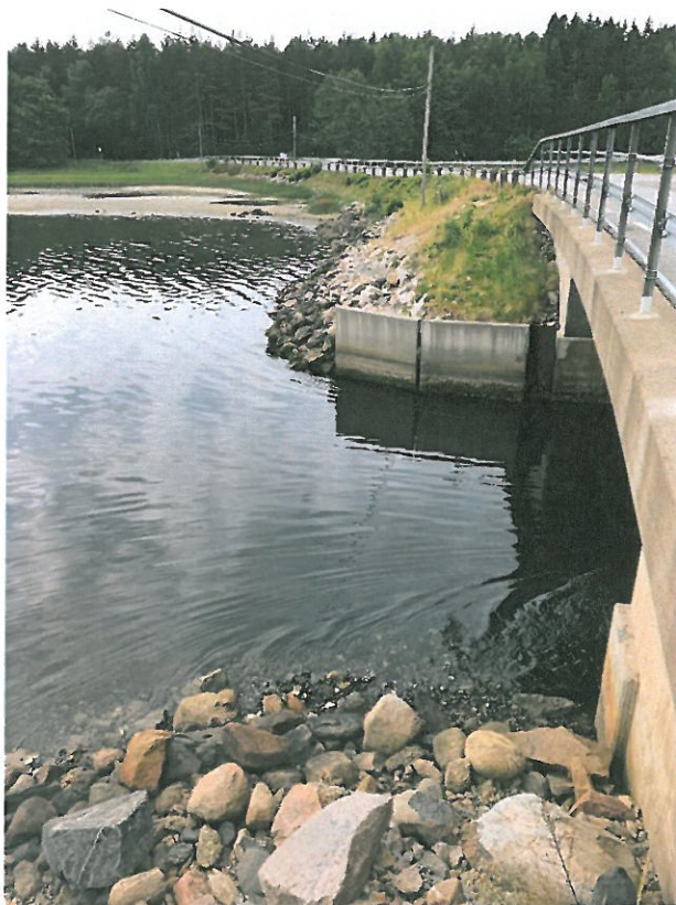
Figur 5. Galtö bro, bild tagen öster om bron, vy mot söder. Vattnet strömmar ut från området (västerut) i bilden, 2018-05-29.
