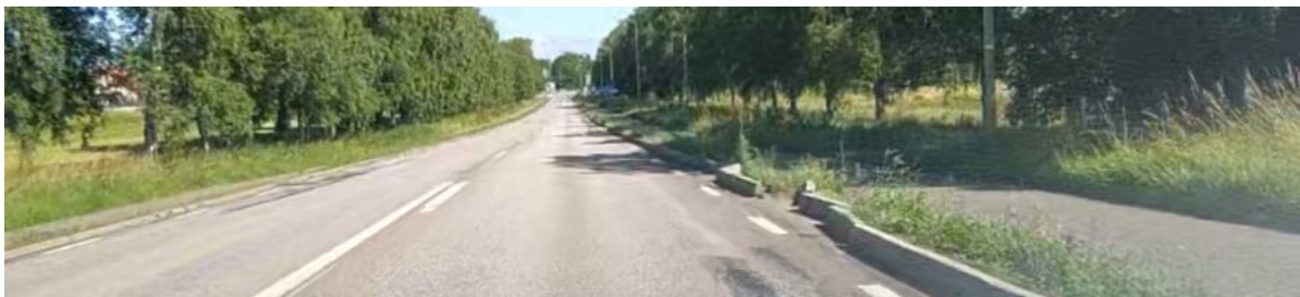
Figur 45. Ett par 100 meter söder om Källegårdsrondelen har kantstenen flyttas på flera ställen. Fotot blickar norrut på väg 49.
