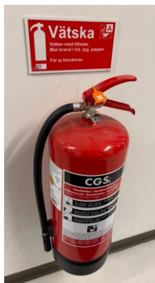
Figur 11. Exempel handbrandsläckare, vätska, med skyltning och uppmärkt datum för extern årlig kontroll (2025).
