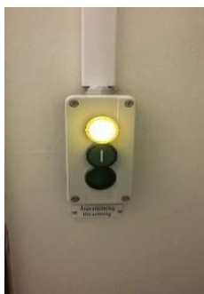
Figur 8. Strömknapp i teknikummet Uddevalla sjukhus.
