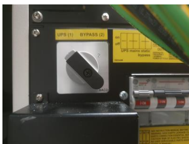
Figur 5. Reglage på UPS:en i teknikrummet på NÄL.
