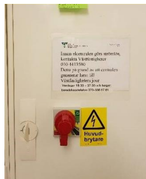
Figur 11. Strömbrytare teknikummet Uddevalla sjukhus.
