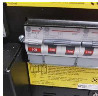
Figur 4. Strömbrytare på UPS:en i teknikrummet på NÄL.
