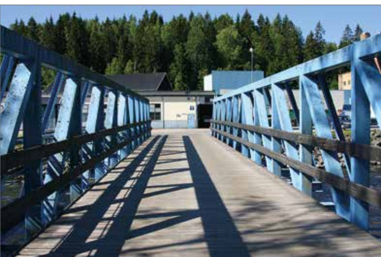
Den södra bron mellan fastlandet och ön där Rexcell ligger (norra bron är den i anslutning till kraftverket). Transporter till och från fabriken går via denna bro. Max fordonsvikt 60 ton. I fonden syns valsliperiet och till vänster byggnad 10. Foto mot öster.
