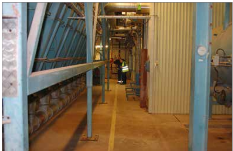
Nedre delen av ITK-filtret.
