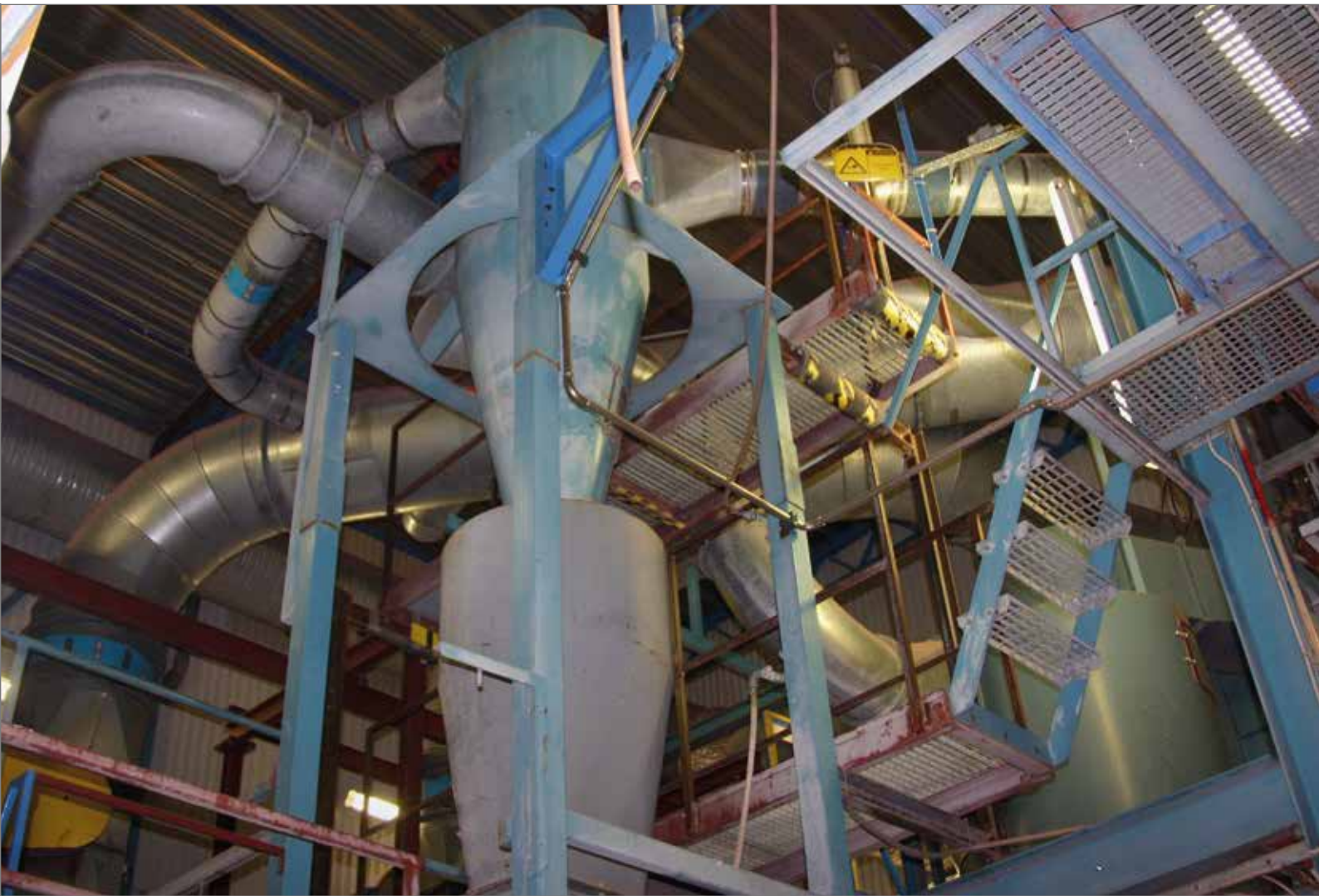
En processindustri har ofta ett omfattande system av rör, filter, fläktar med mera. Bilden visar delar av rörsystemet vid ITK-filtret.
