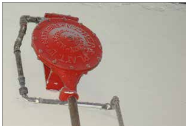
Byggnad 1d. Larmklocka för sprinklersystemet. När vattnet rusar igenom klockan så ljuder brandsignalen.
