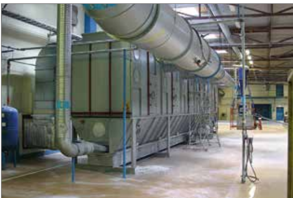
Byggnad 1d. Dan Webb-filtret. En del av TM 2.
