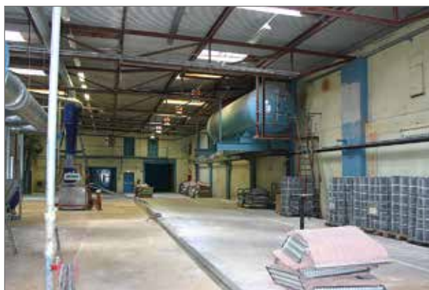
Byggnad 1d. Cisternen är en del av sprinklersystemet och till vänster skimtar Dan webb-filtret.
