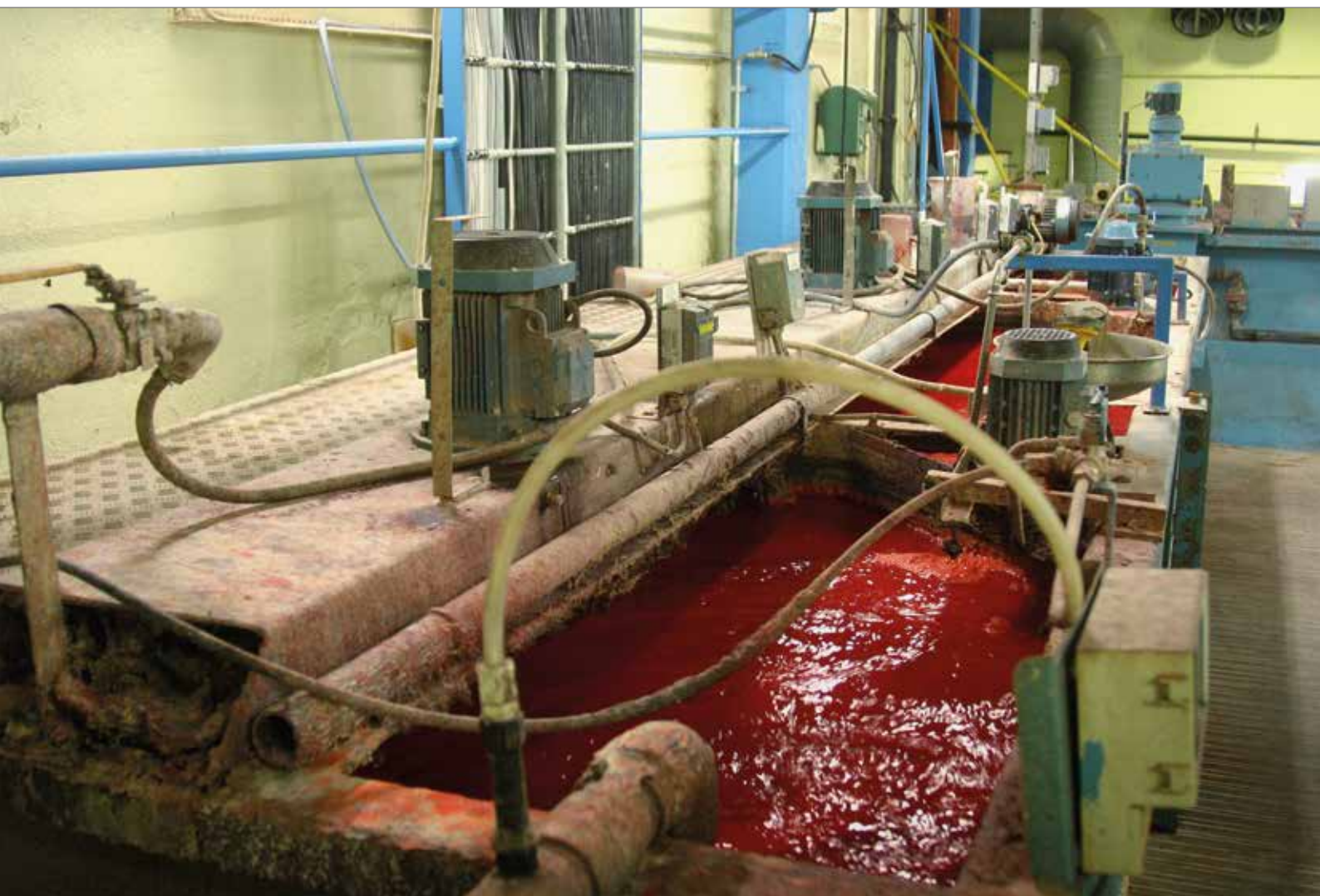
Spillvattnet på väg in i reningsanläggningen.
