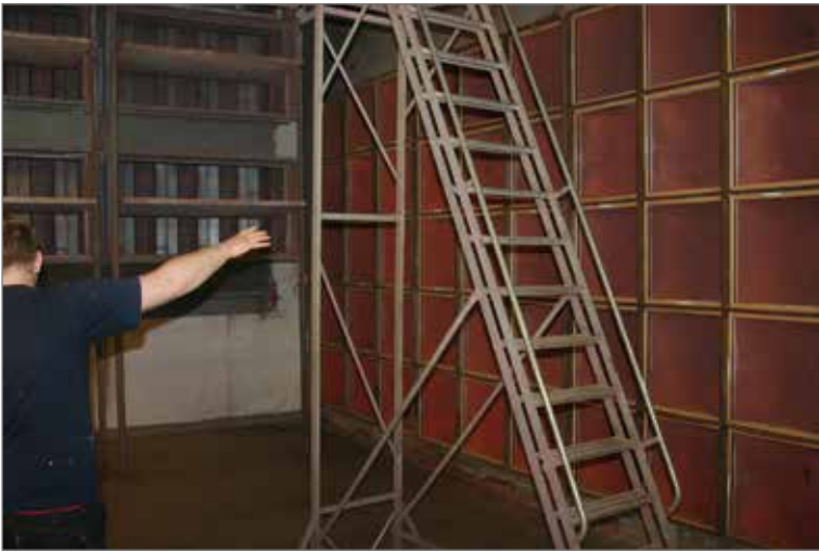
Klimatanläggningen. Blandkammaren med finfiltrervägg.
