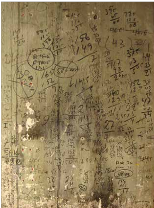
Istället för miniräknare och dator!? Det går att konstatera att det flesta uppställningar är korrekt uträknade. Finns noterat på en pelare i byggnad 2.
