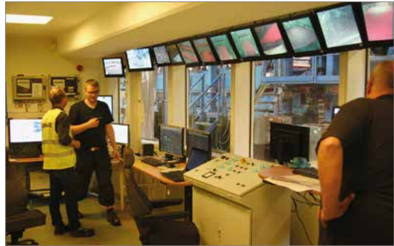
Kontrollrummet. TM 2 skymtar till höger utanför rutorna.
