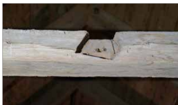
Knut med nacke och hål efter dymling i skarpkantad hanbjälke, troligen äldre högben.
