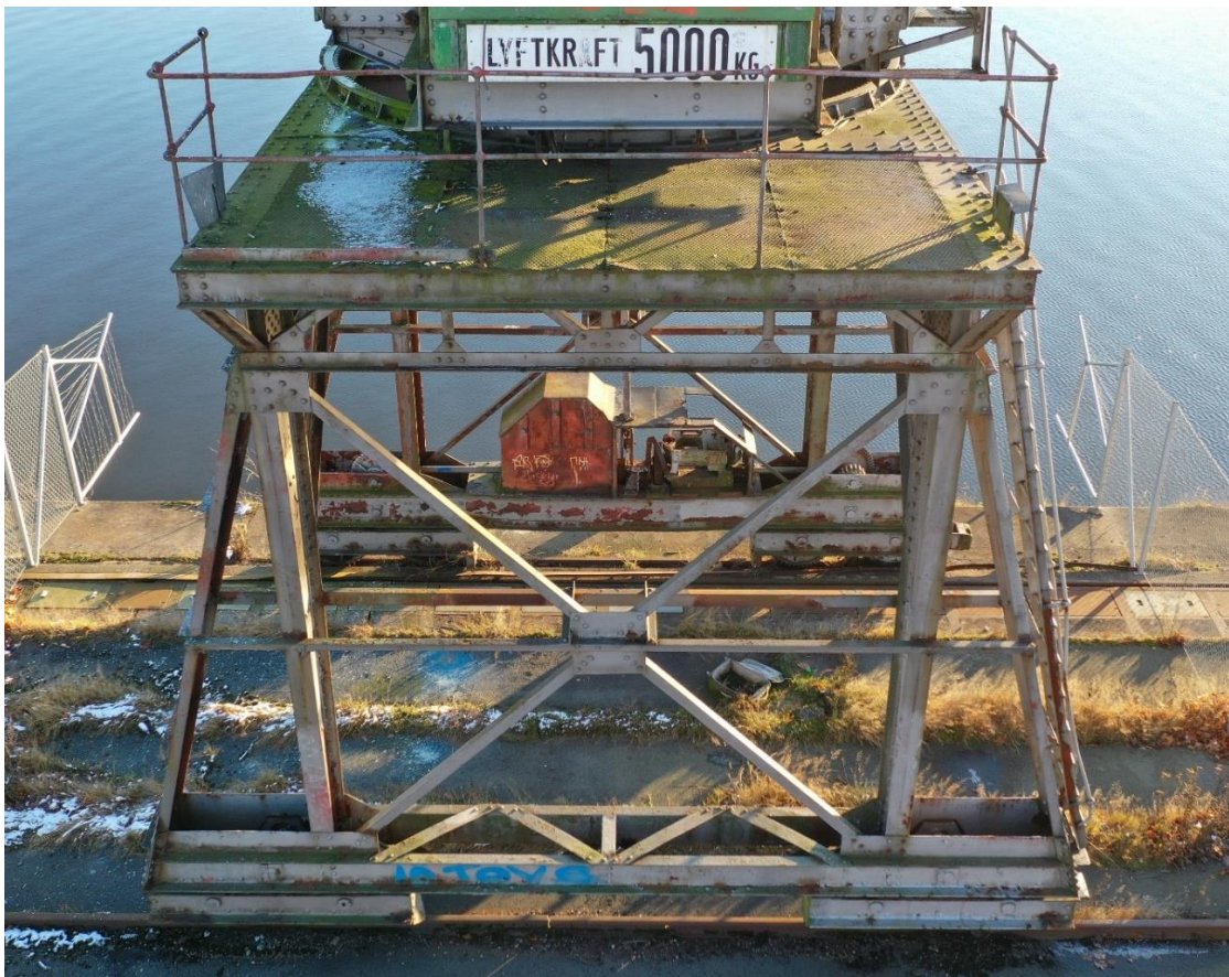
Elmotor, växellåda och kardanaxlar med vinkelväxlar ses på det borte benparet. Benparet närmast har ingen drivanordning. Vid körning får man reglera start och stopp med en viss finesse för att undvika ryck i själva portalen.
