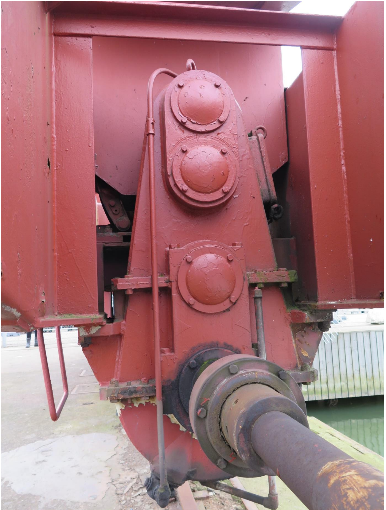
Åkmaskineriet med elmotor och utgående kardanaxel på norra portalbenet.
