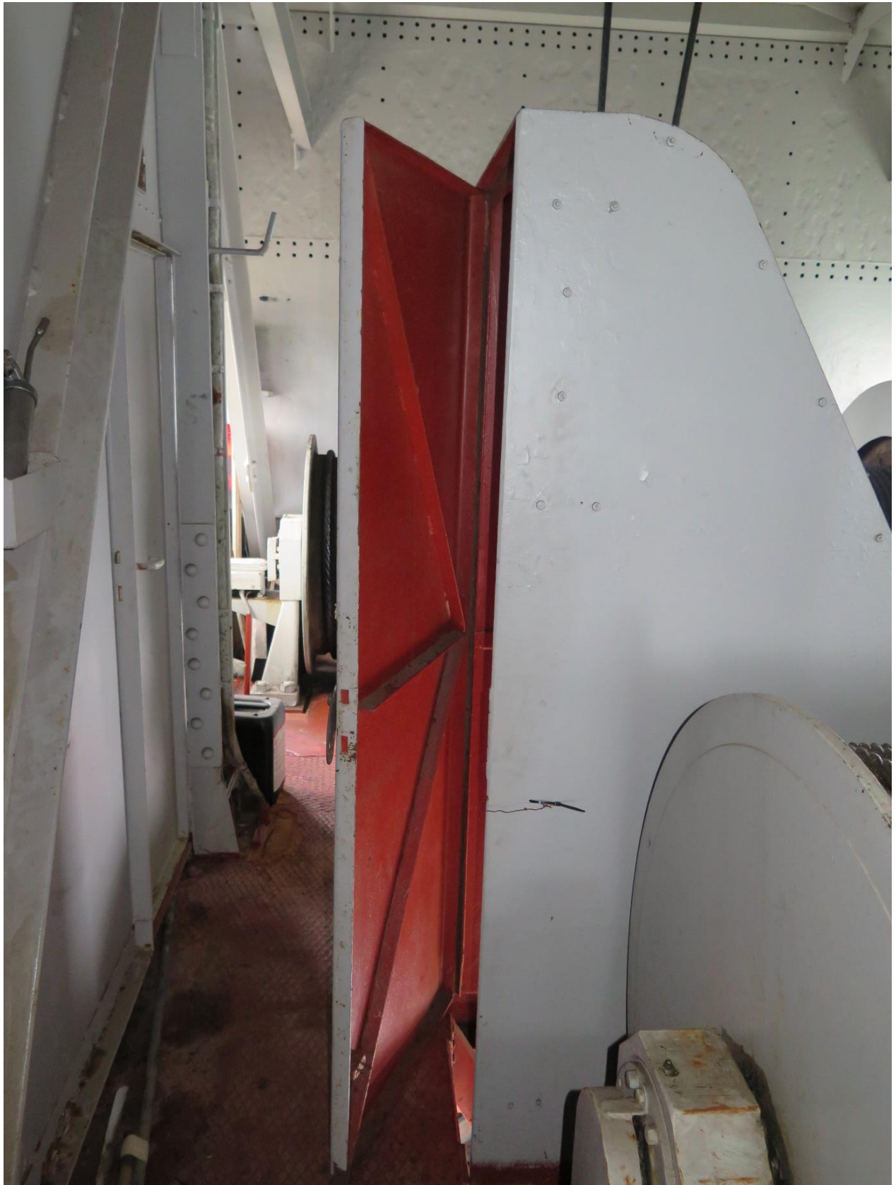
Maskinrummet. Dörren som leder ut till trappan som ses på föregående bild.
