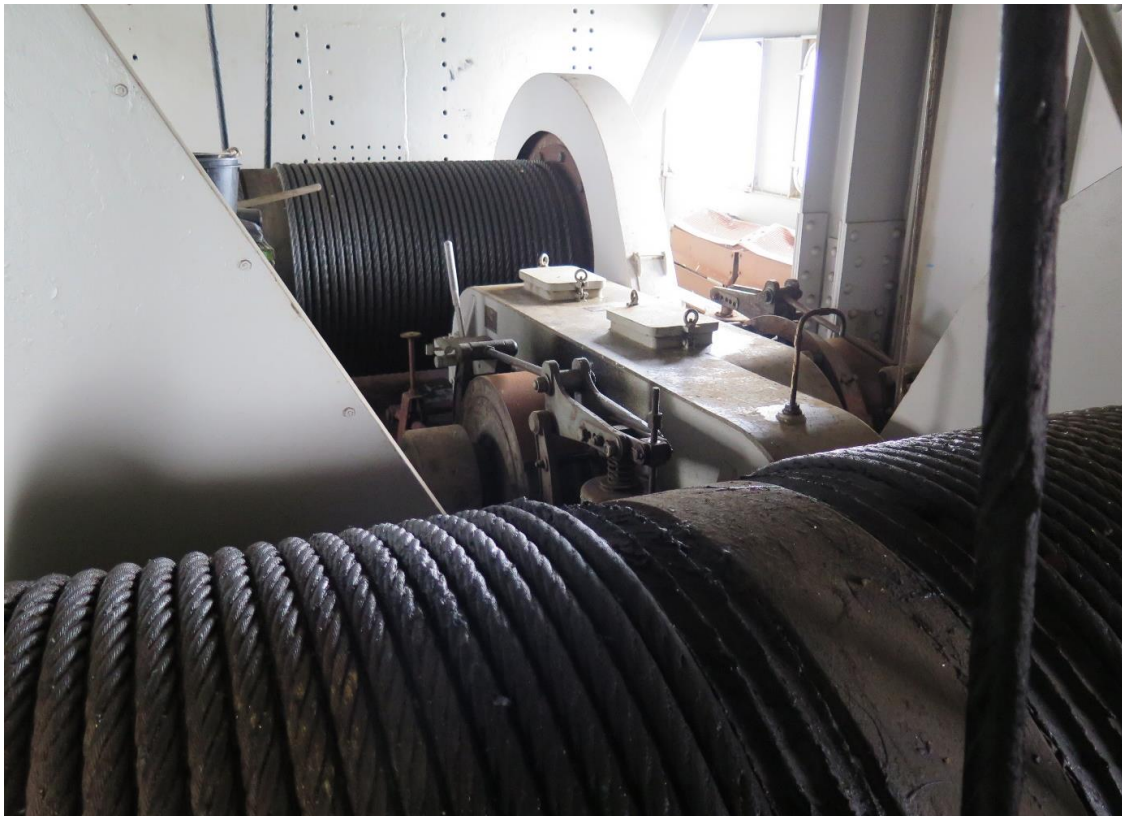
Vajertrummorna i maskinrummet. Längst bort trumman till stora kroken och närmast till kranjibben.
