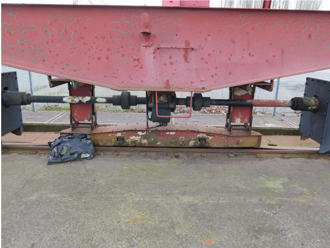
Elmatningen till kranen sker via en strömförande skena under marknivå.
