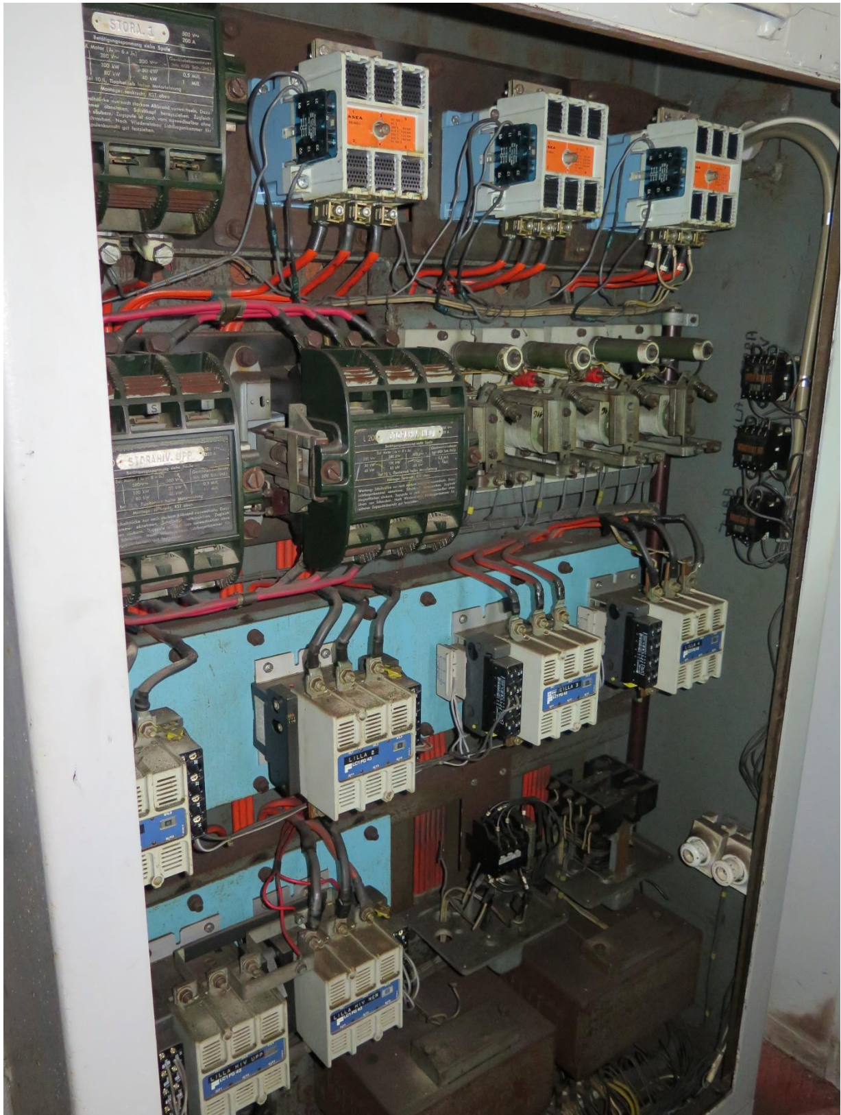
Elcentralen i maskinrummet. En motsvarande elcentral finns på andra sidan.
