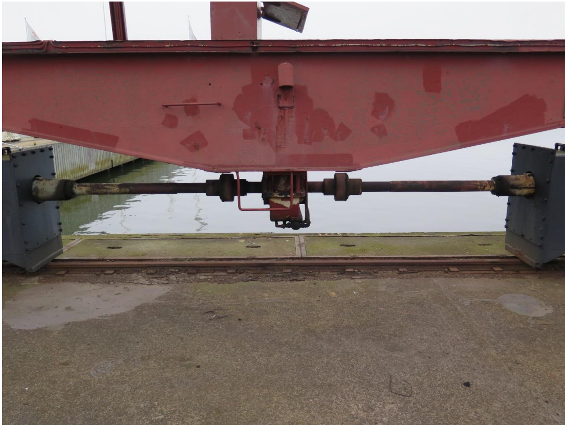
Foto mot norr med elmotor och kardanaxlar för driften av kranboggierna.
