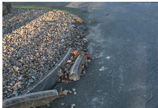
Skador orsakade av snö och/eller snöröjning ska åtgärdas så snart som möjligt.
