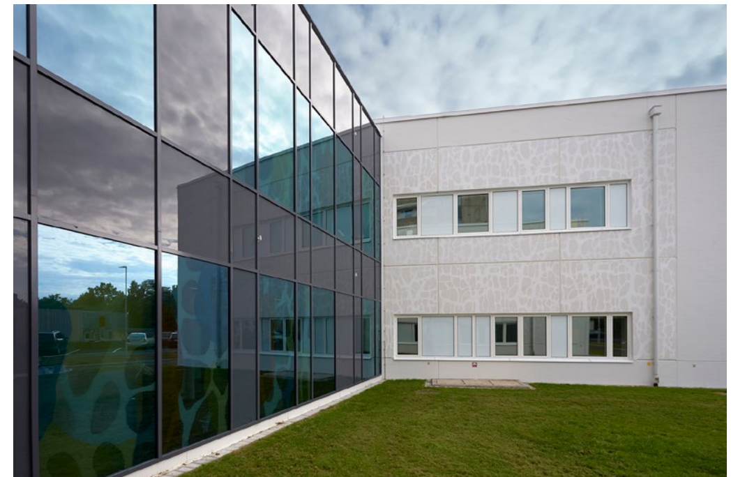
Växande på glasfasad och på betongfasad.
